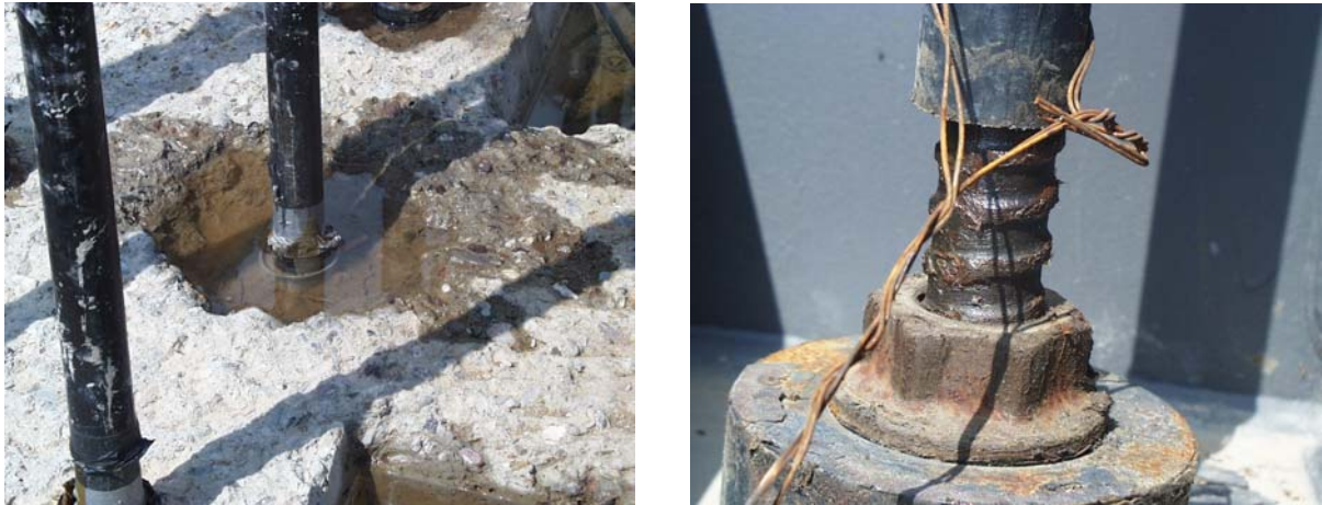
Bild 4: „Fehlender temporärer Korrosionsschutz!“
