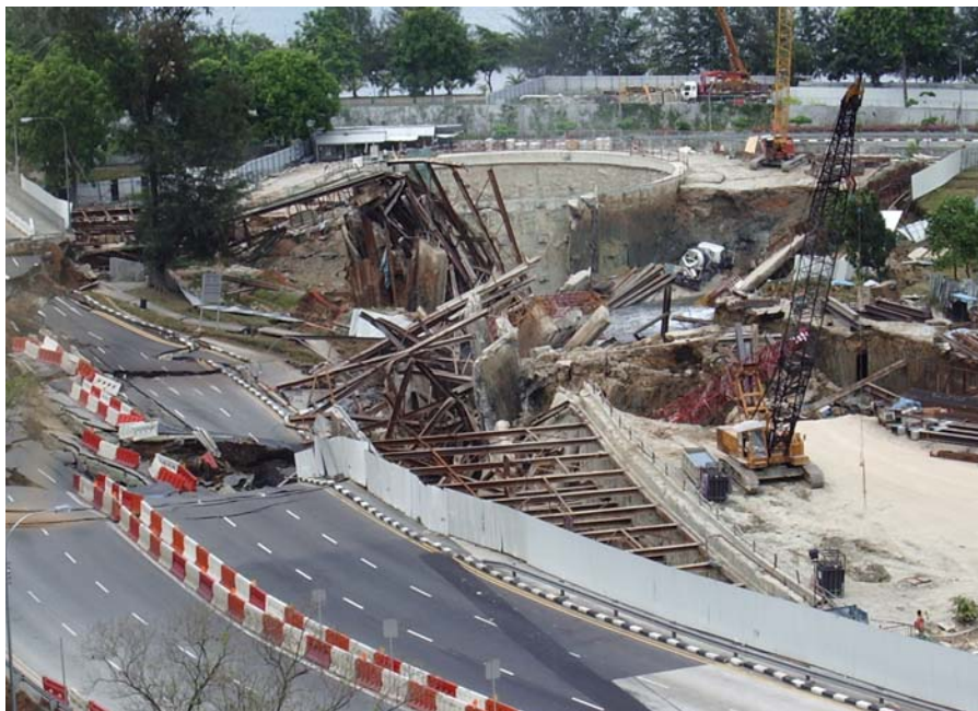
Bild 1 Nicoll Highway Kollaps, Singapore
